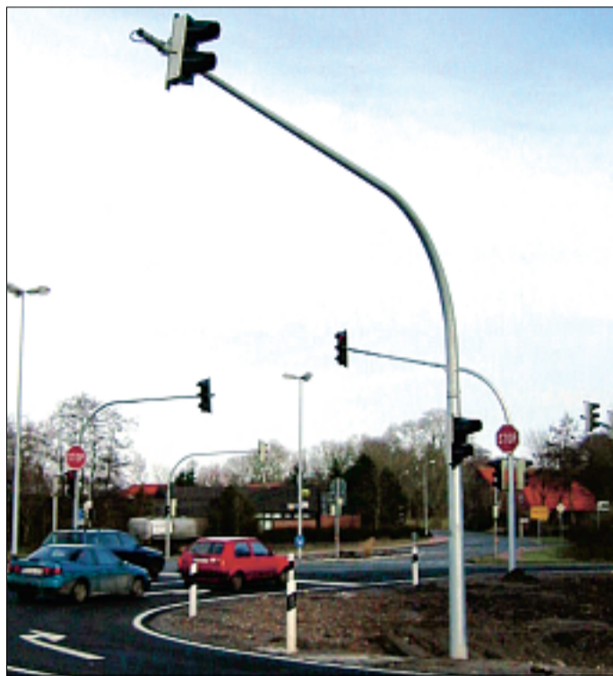
Die Vorampel vor der großen Kreuzung in Marienhafte tritt nur dann in Aktion, wenn sich der Verkehr auf der Rosenstraße staut.
